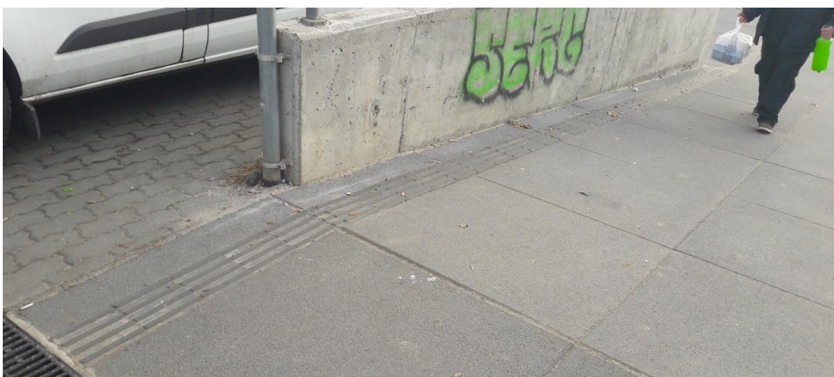
Sofijské náměstí – řešení umělé vodící linie bez oboustranného odstupu, špatná velikost hmatového prvku; zdroj: archiv NRZP ČR
