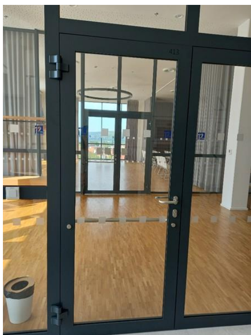
Radnice ÚMČ P12 - Nedostatečný kontrast prosklených ploch; zdroj: archiv POV
