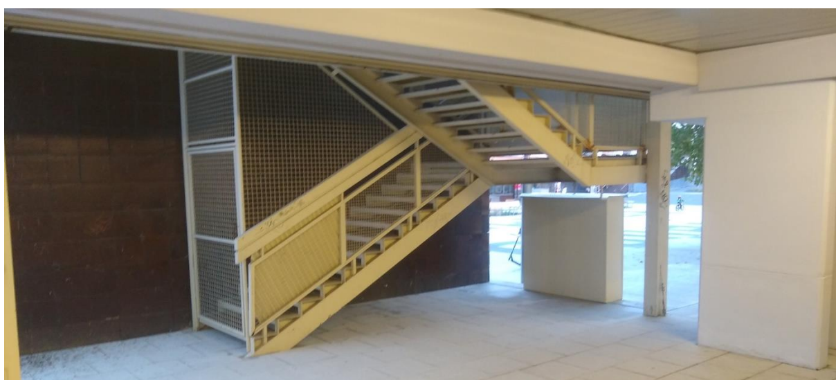
Sofijské náměstí – neohraničené překážky v prostoru (schodiště bez zamezení vstupu do snížené podchozí výšky konstrukce; zdroj: archiv NRZP ČR)
