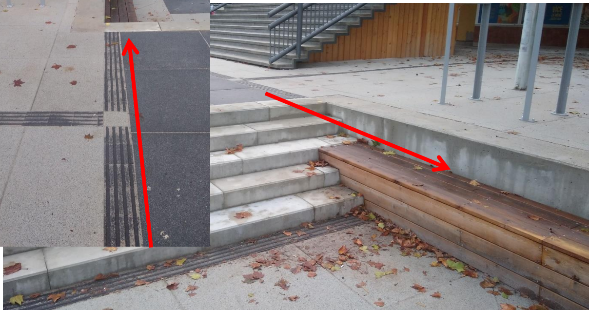
Sofijské náměstí – řešení umělé vodící linie bez oboustranného odstupu, špatná velikost hmatového prvku, navedení nevidomého na lavičku; zdroj: archiv NRZP ČR
